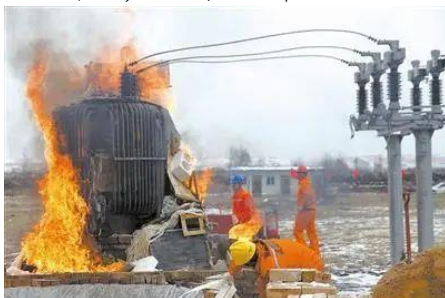
图 22 模拟变压器故障场景图
