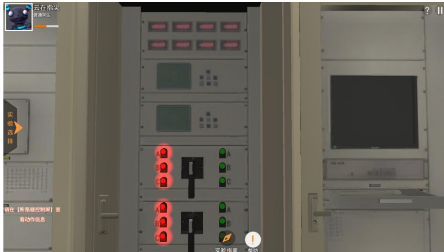
图 6 虚拟变电站内断路器控制屏场景图
